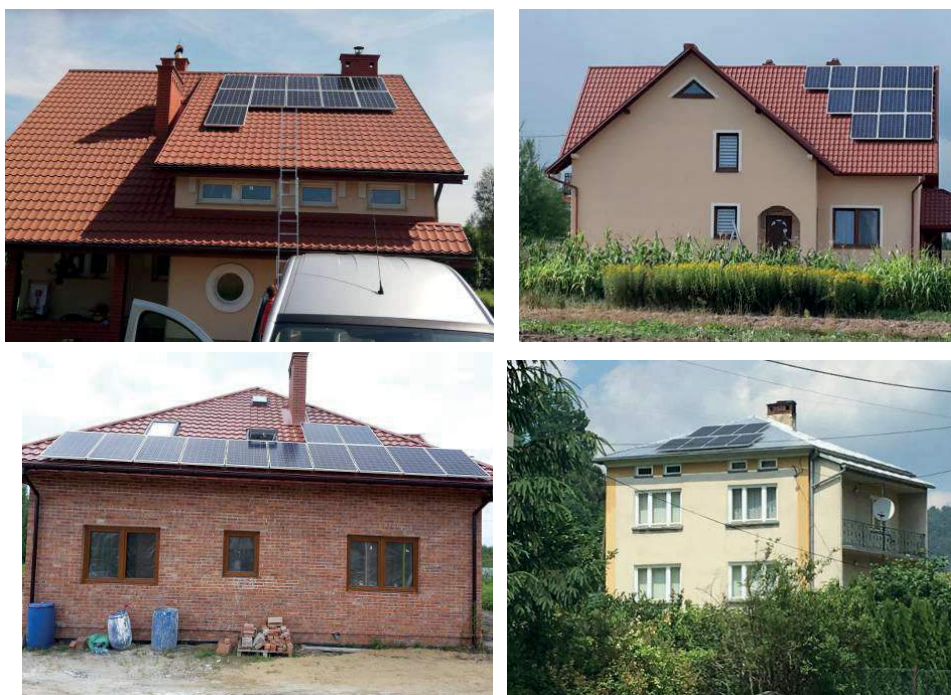
Rys. 1A. Instalacje fotowoltaiczne montowane na domach mieszkańców gmin Lesko, Jaślicka i Rymanów w województwie podkarpackim.
