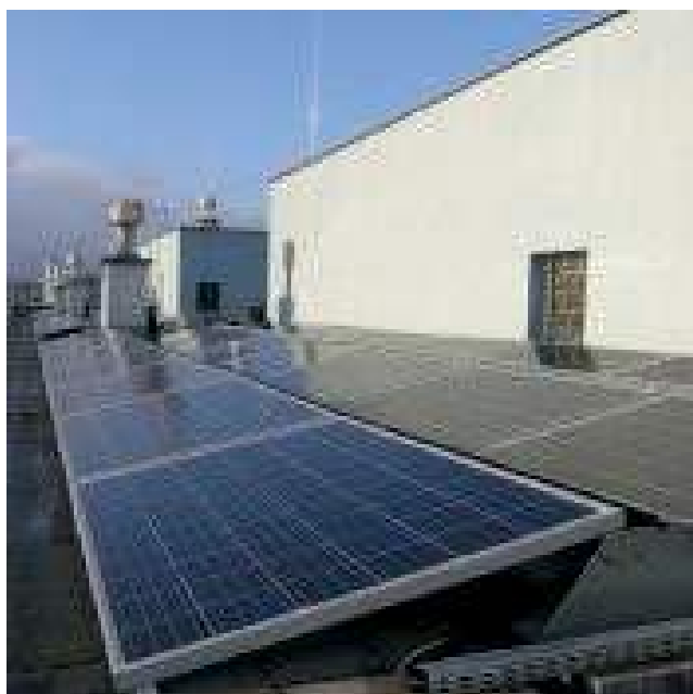
Fot. 3. Instalacje ogniw fotowoltaicznych na budynkach Spółdzielni Mieszkaniowej Wrocław Południe.
